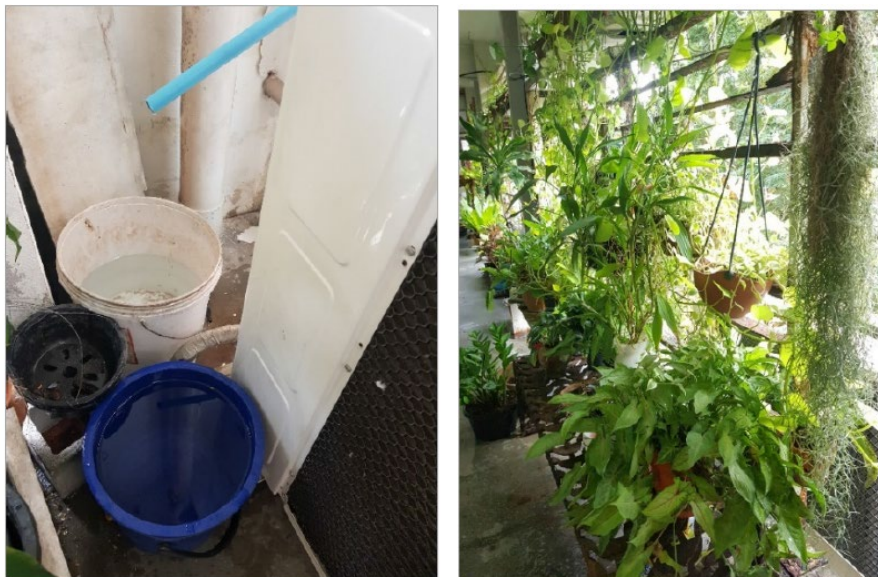
ภาพที่ 3.13 ติดตั้งอุปกรณ์รับน้ำจากระบบปรับอากาศเพื่อใช้รดน้ำต้นไม้
